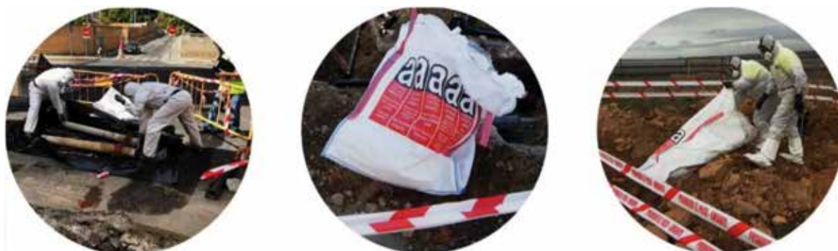
Fig. 2. Embalaje de residuos de amianto mediante bolsas de plástico posteriormente etiquetadas (izquierda), bolsas Big Bag homologadas de embalaje de residuos (centro y derecha).
