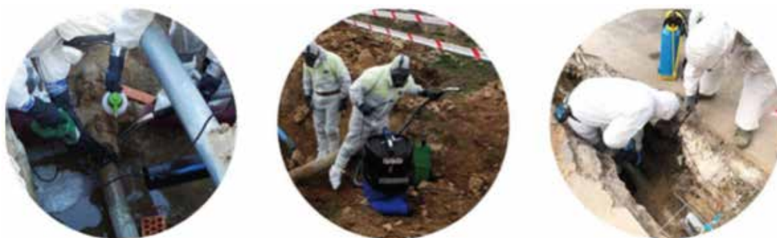
Fig. 5. Humectación con líquido encapsulante durante la realización del trabajo de corte en combinación con aspirado de la zona de trabajo (izquierda), humectador y aspirador preparados para los trabajos (centro), humectación durante la realización de los trabajos de corte (derecha). Observación: la imagen central muestra una incorrecta colocación de la máscara integral, debiendo estar cubierta por el mono, y no por fuera del mismo.
